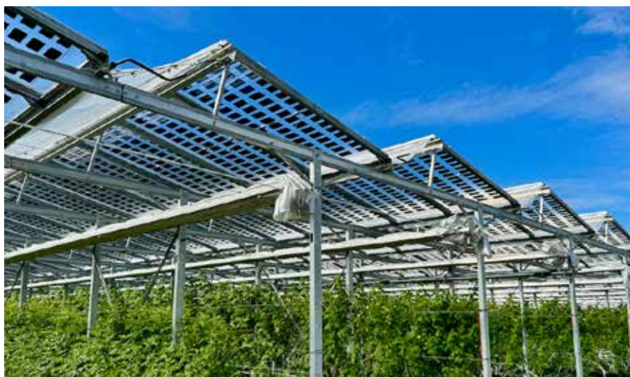
Agri-PV in Conthey: Diese Panels sind lichtdurchlässig.
