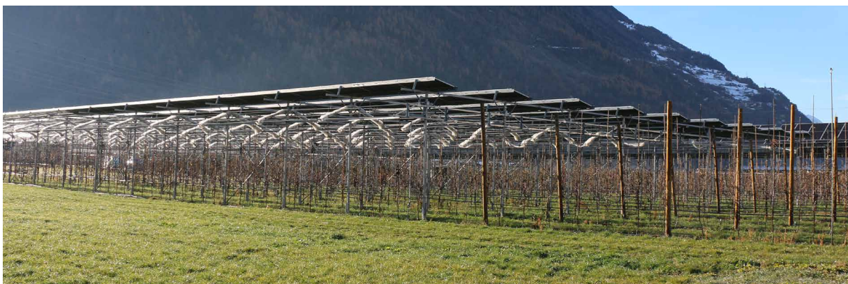
Conthey abrite également une installation agrivoltaïque.
