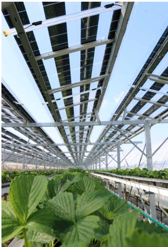
Installation agro-photovoltaïque au-dessus de cultures de fraises et de framboises.
